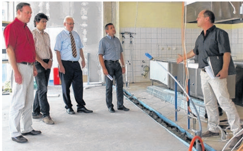
Ein Bild von den Umbau-, Modernisierungs- und Erweiterungsmaßnahmen der Cafeteria des MSG machten sich unter Leitung von Architekt Frank Kaiser (rechts) Bürgermeister Thomas Maertens, Stadtbaumeister Tobias Blessing, Schulleiter Dr. Jürgen Gernert und Hauptamtsleiter Jürgen Umminger (von rechts). BILD: PETER D. WAGNER
